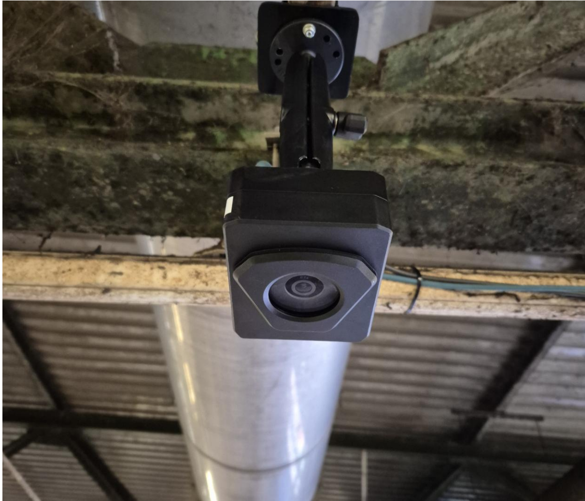
Deckeninstallation der Kamera in Entsorgungshalle der KAVG
